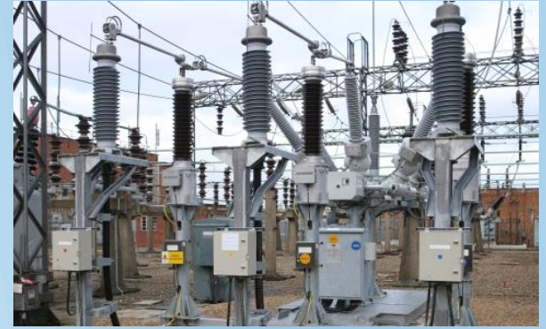
HV Switch Gears
